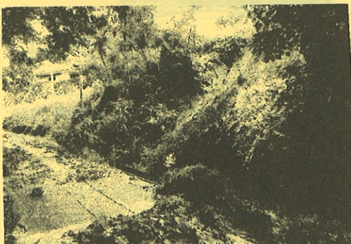
▲ 平成24年7月梅雨豪雨による のり面崩落の一例(竹ノ内地区)
