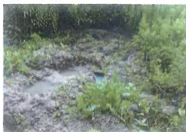
民家の裏 被害
