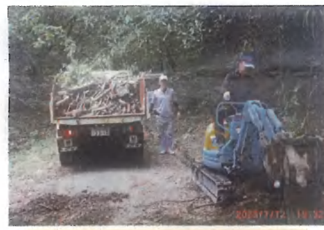
峠道の側溝の詰りで雨水のあふれ出す危険性解消！ みぞほりは誰にも負けん！そうです。
