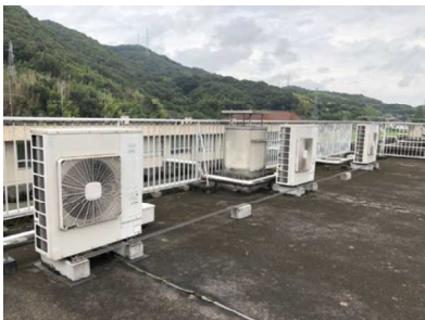
南棟屋上室外機
