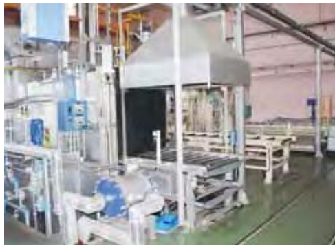
自社開発された浸炭焼入れのライン
