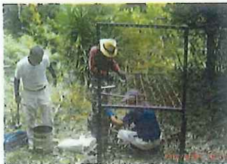
箱罠 捕獲できなくなった場所の罠を移動する前にメッシュ等の補修
