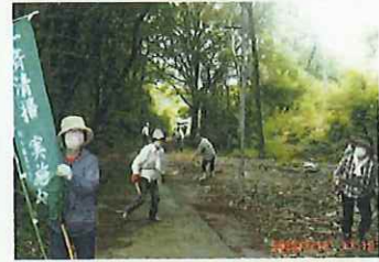
昼間でも暗い坂道でしたが、不用の樹木の処理で安心して通行できます。
