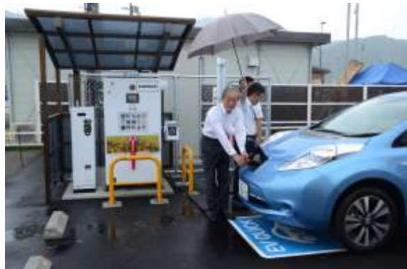
電気自動車用急速充電器供用開始(7月)
